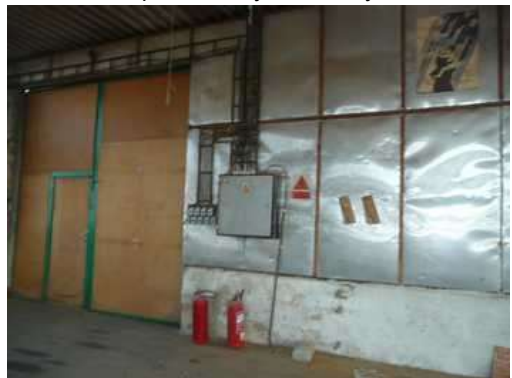
vrata s el. rozvaděčem
